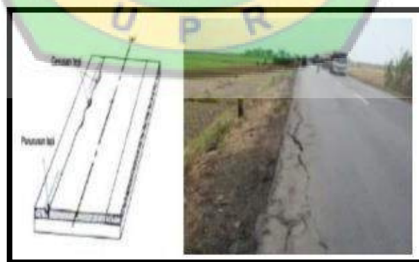
Gambar 2.27 Retak Pinggir ( Edge Cracking )
